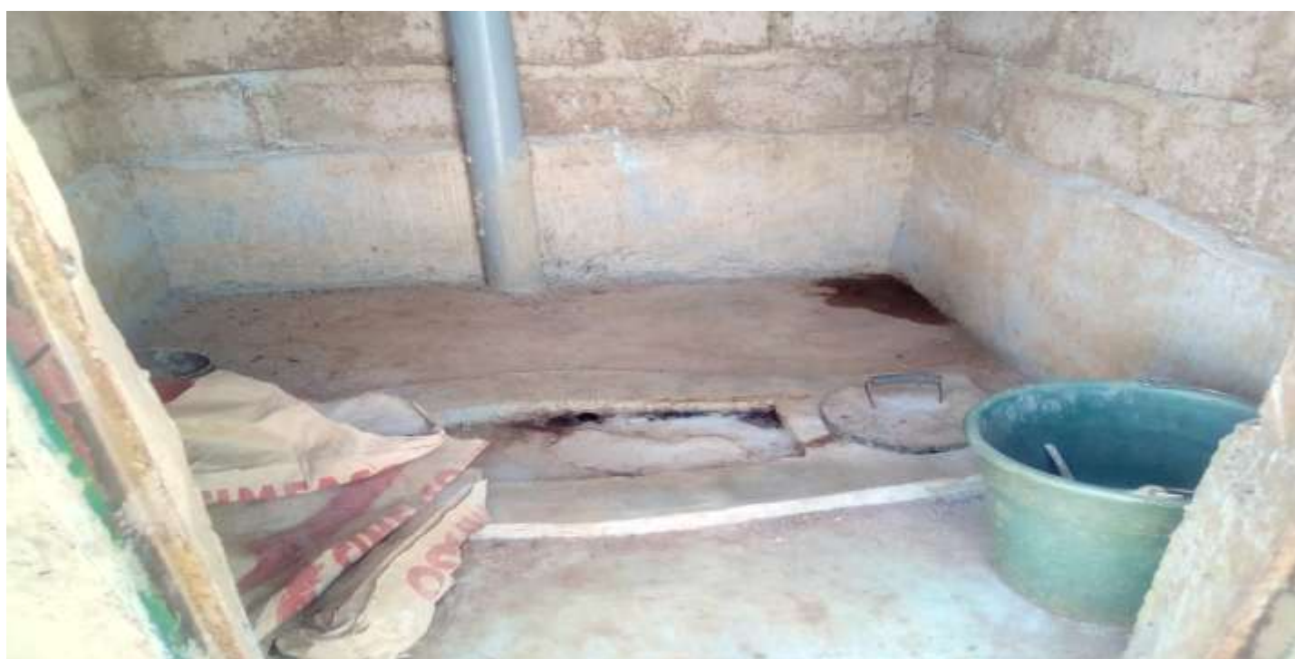
Suivie de l'utilisation et entretien de latrine de 2022
