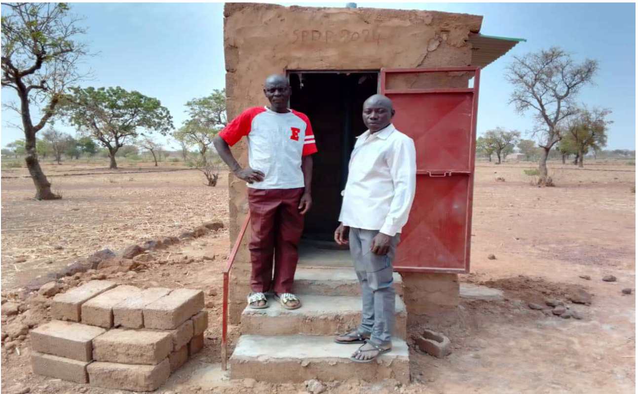
Photo de finition de construction de latrine de 2024 dans le quartier Koukouldissi
